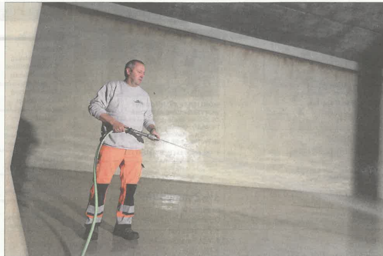
Franz Muheim im 1000 Kubikmeter fassenden Wasserreservoir Kohlplatz oberhalb von Flüelen. Alle ein bis zwei Jahre wird das Wasser für Revisionsarbeiten abgelassen. FOTOS: DORIS MARTY.
