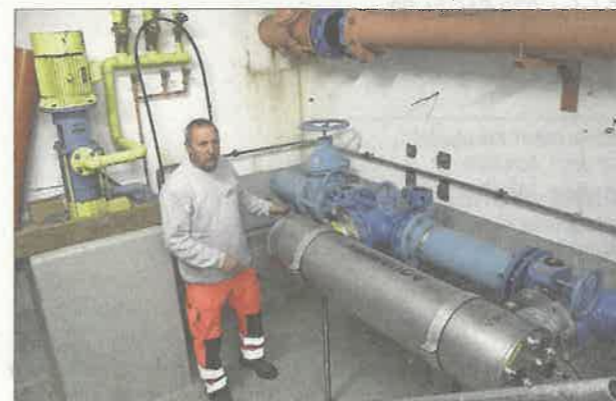
Durch diese dicken Rohre strömt das Quellwasser ins Reservoir.
